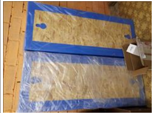
Стеновой протектор ОСБ плита 0,5х1,25м Зал самбо п. Арамил, ул. Станционная, 1Е
